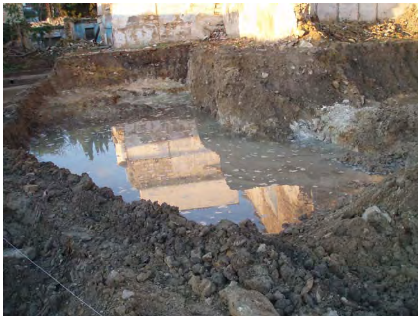
Lam. 23.- Surgencia del nivel freático.
