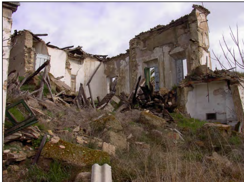
Lám., 46. Estado de ruina del edificio, año 2003.
